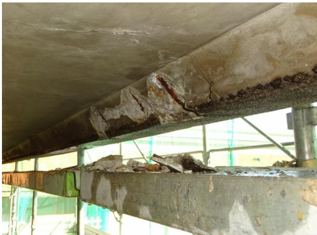
Parti ammalorate della facciata
